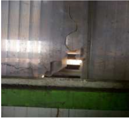
Abbildung 2: Loch in der Wand bzw. Spalt unter der Tür: Eindringen von Schädlingen und Schmutz
