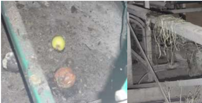
Abbildung 3: Mangelhafter Reinigungszustand: Anlocken von Schädlingen, Produktkontamination
